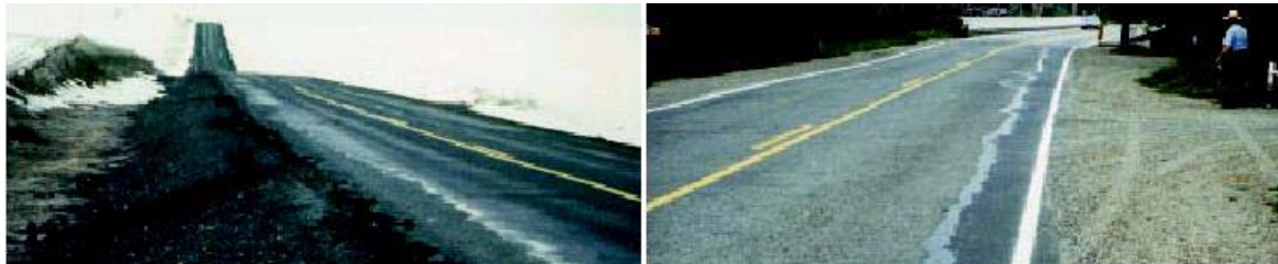
Σχήμα 3.13-1: Αποκόλληση αδρανών στις ακμές του οδοστρώματος
